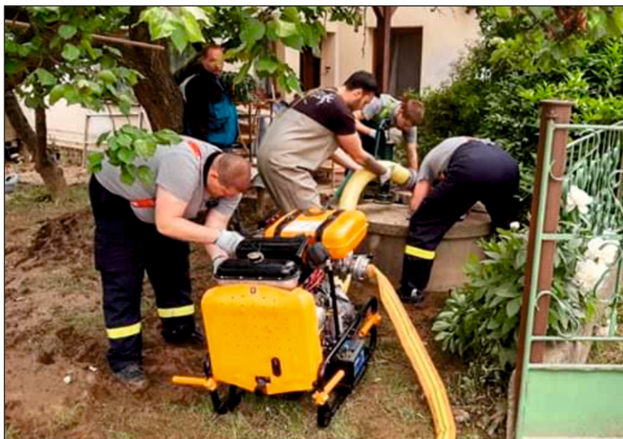
Čerpání studny po povodni v obci Šumvald
