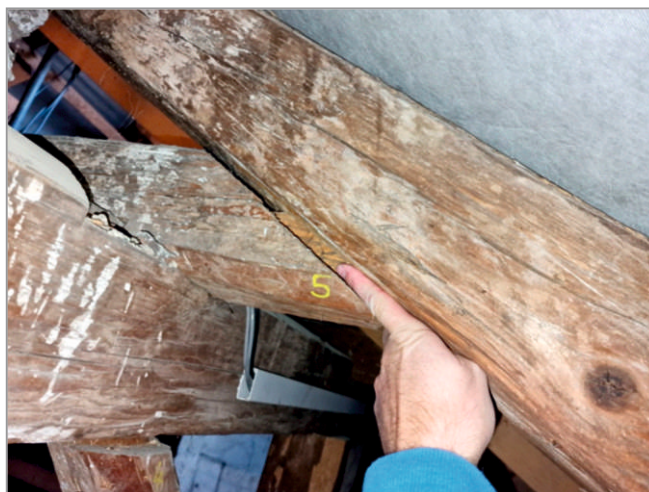
Povolená střešní konstrukce, ke které došlo chybnou opravou v roce 2020
