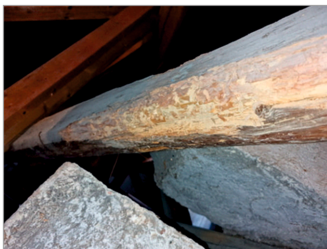
Trám střešní konstrukce narušený dřevokazným hmyzem
