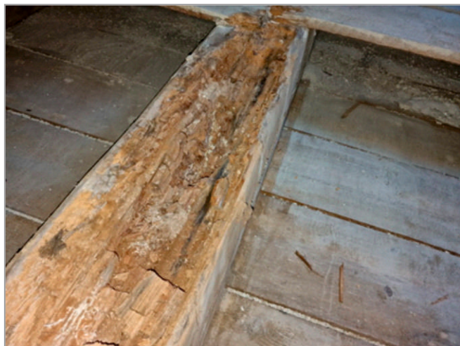
Shnilý nosný trám ve stropu
