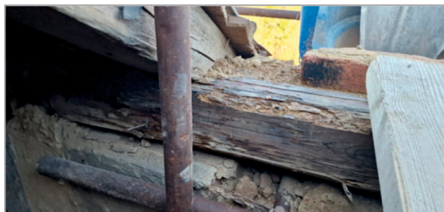
Uhnilá pozednice ve střeše
