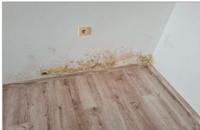
Plíseň v jedné z místností v bytě
