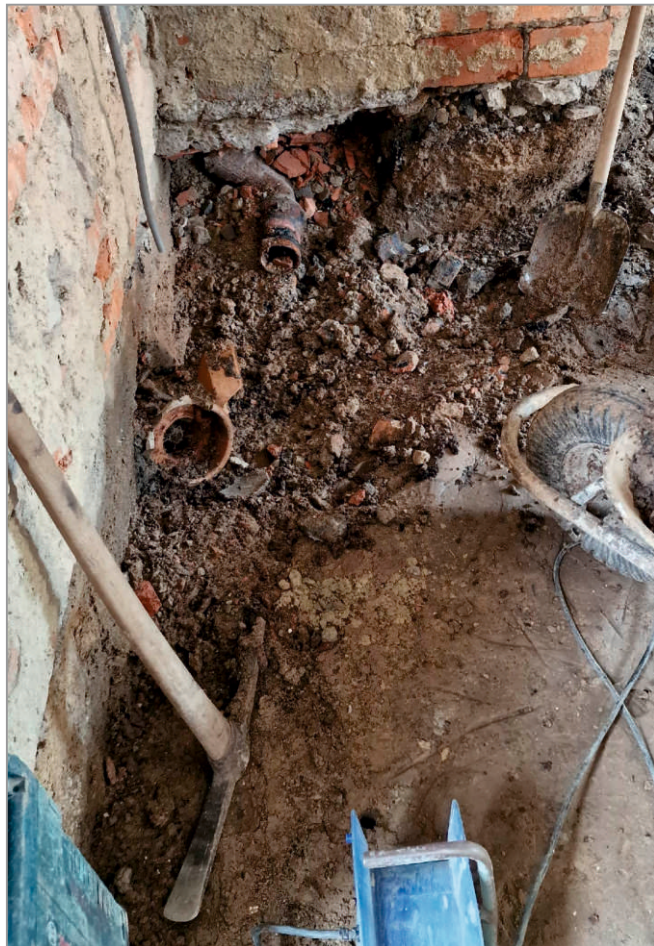
Vadná prosakující kanalizace pod budovu
