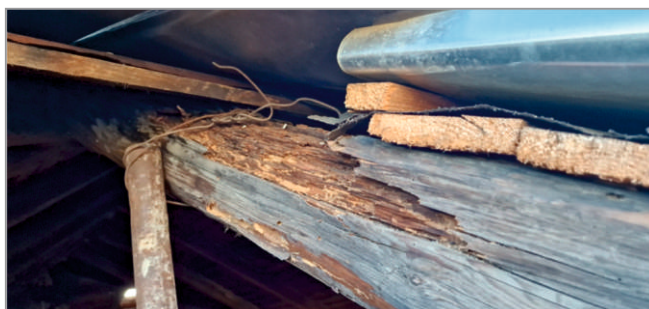
Jedna z uhnílych krovů ve střeše MŠ
